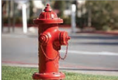
شکل ۲- نمونه هایدرانت نصب شده در محوطه
