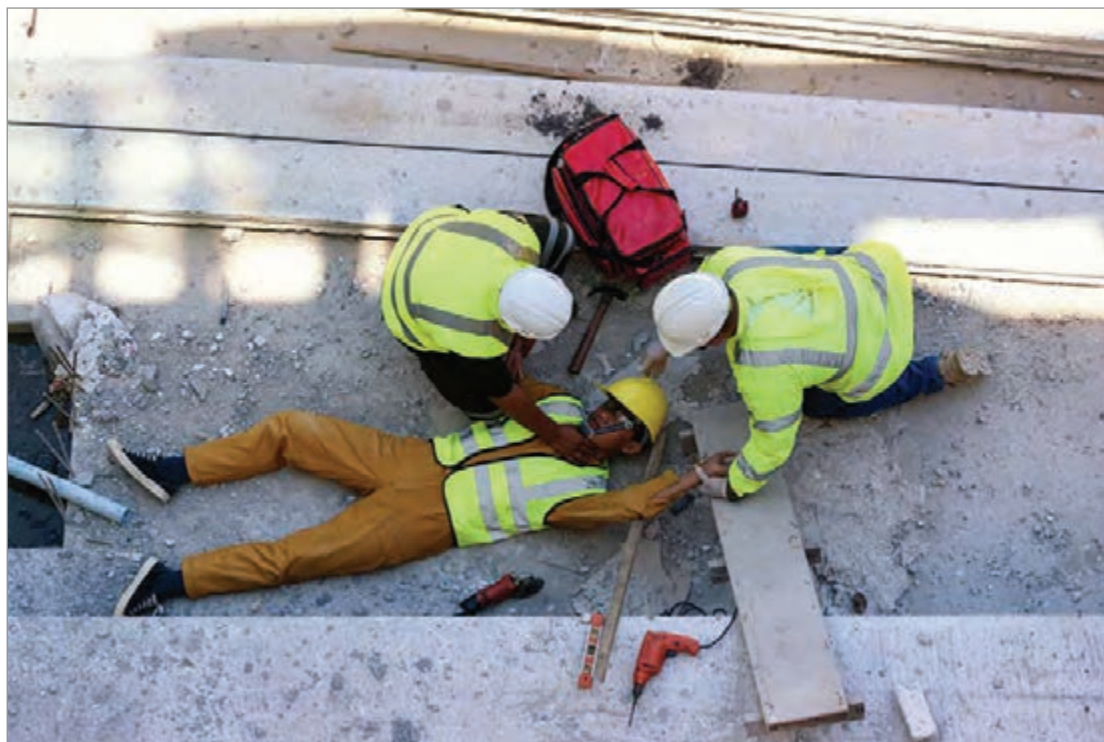
شکل ۱۲- حادثه سقوط از ارتفاع پرسنل مهندسی
