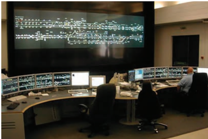
شکل ۴۴- فضای کاری مرکز فرمان
