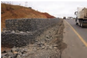
شکل ۱۰- دیوارهای گابیونی کنار راه
