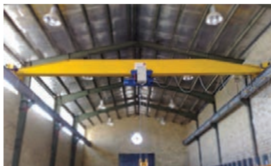
شکل ۲۱- نمایی از جرثقیل سقفی (تک پل)
