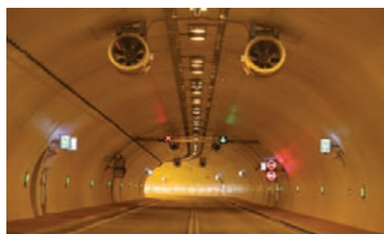
شکل ۱۸- تهویه‌های هوای نصب شده در تونل
