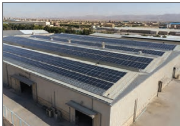
شکل ۳۴ - سیستم متصل به شبکه در پشت بام سوله‌های یک کارخانه صنعتی
