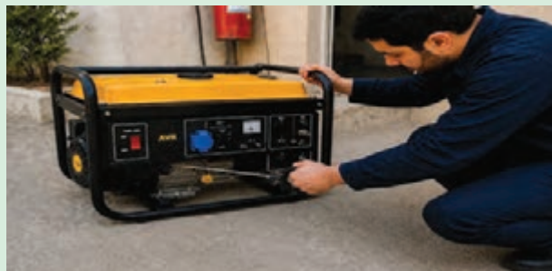
شکل ۹- راه اندازی مولد برق اضطراری
