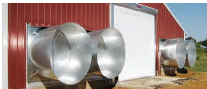
شکل ۲۸- نصب هواکش‌ها به صورت قرینه در تهویه تونلی
