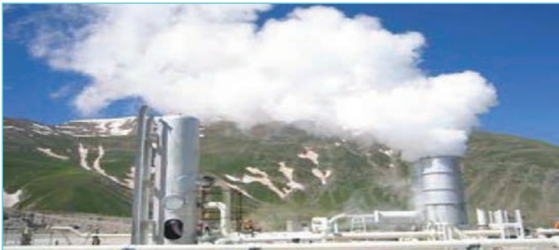
شکل ۲۴-۵- تأسیسات زمین گرمایی مشکین شهر
