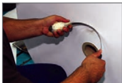
شکل ۵- برطرف کردن آسیب روی بدنه رول
