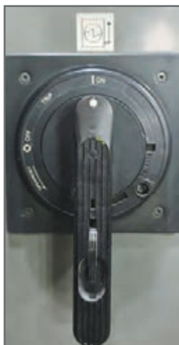
شکل ۶- کلید اصلی برق در حالت روشن
