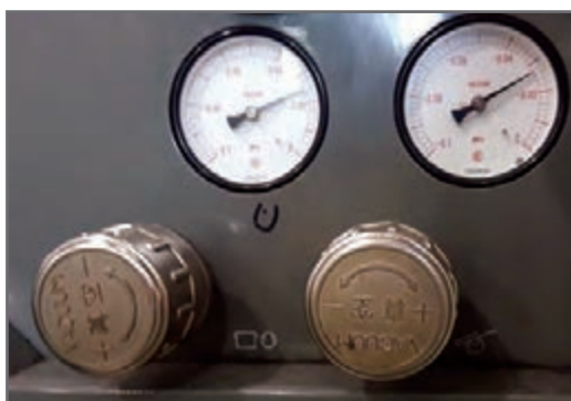
شکل ۳۲- شیر تنظیم مکش - شیر سمت چپ
