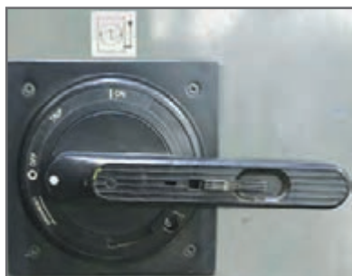
شکل ۵- کلید اصلی برق در حالت خاموش
