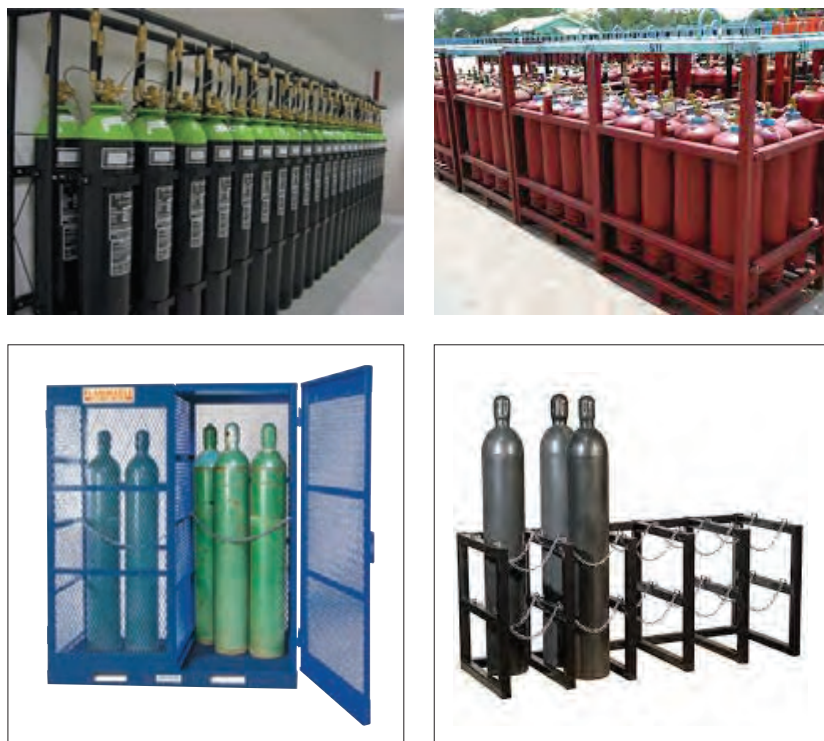
شکل ۱۲- نحوه نگهداری کپسول‌های گاز مورد استفاده در جوشکاری و برش کاری
