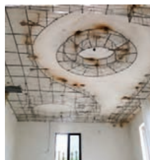
شکل ۸۷- سقف کاذب رابیتس
