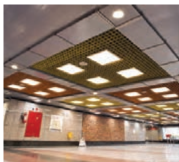
شکل ۸۹- سقف کاذب گریلیوم
