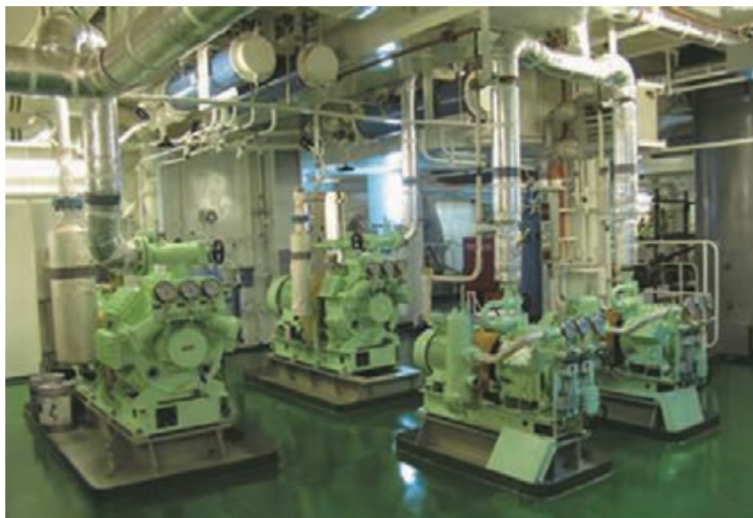
شکل ۱۹- کمپرسورهای هوا در ساختمان کشتی
