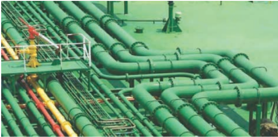
شکل ۲۹- سامانه لوله‌کشی روی عرشه یک نفتکش
