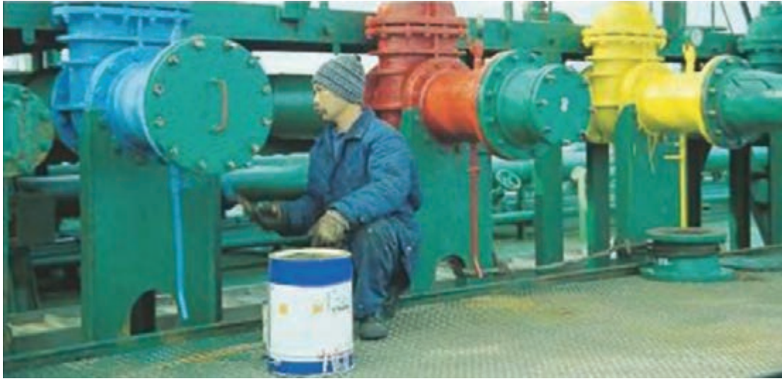
شکل ۵۵- رنگ آمیزی سامانه‌های لوله‌کشی بر روی عرشه
