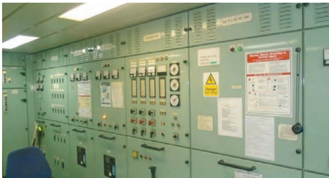
شکل ۲۳- تابلوی اصلی برق شناور
