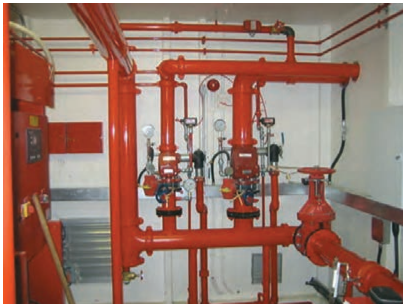
شکل ۱۰- قسمتی از سامانه آتش نشانی یک شناور
