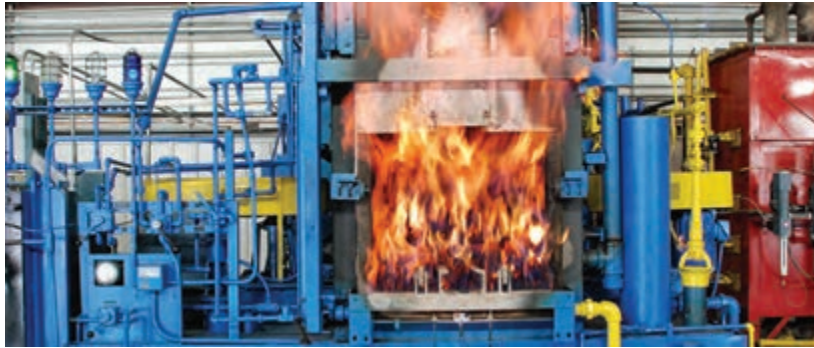
شکل ۵- کوره با اتمسفر کنترل شده
