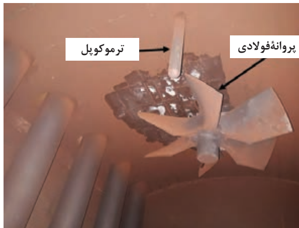
شکل ۱۴- فن گردش هوا در داخل کوره
