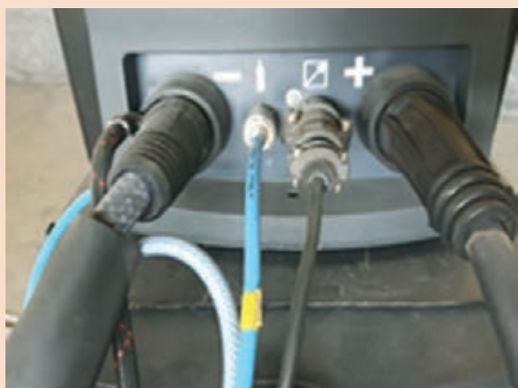
شکل ۹- کابل اتصال سوئیچی
