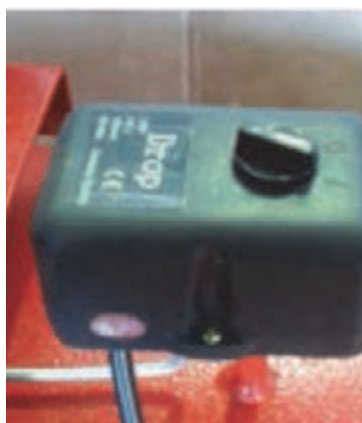
شکل ۱۸۸- جعبه کلید قطع و وصل جریان برق
