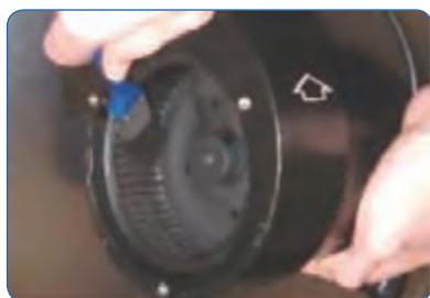
تمیزکردن فن مشعل از گردوغبار
