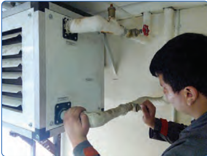
شکل ۱۵- کنترل شیرهای رفت و برگشت و شیر هواگیری یونیت هیتر آب گرم
