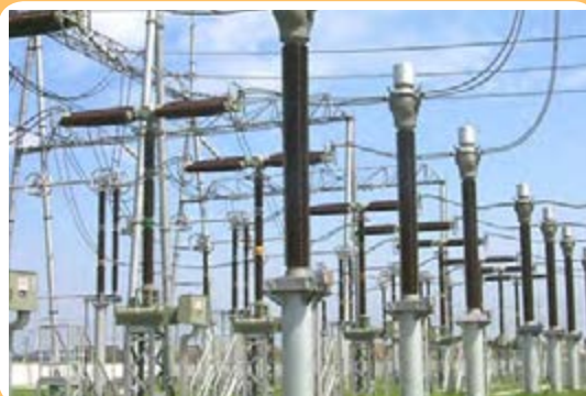
پست تقویت ولتاژ جریان برق
