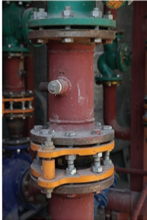
شکل ۲۰- ارتعاش گیر روی پمپ
