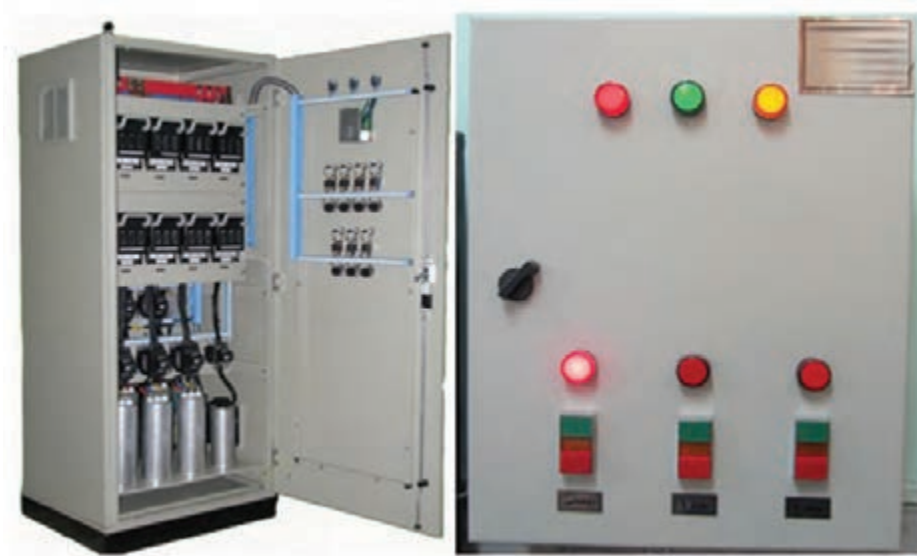
شکل ۴- تابلو برق ایستاده
