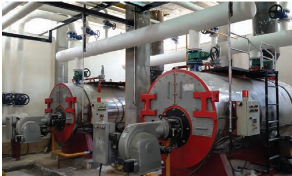
شکل ۲- نمایی از یک موتورخانه
