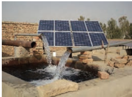
تأمین برق چاه آب
