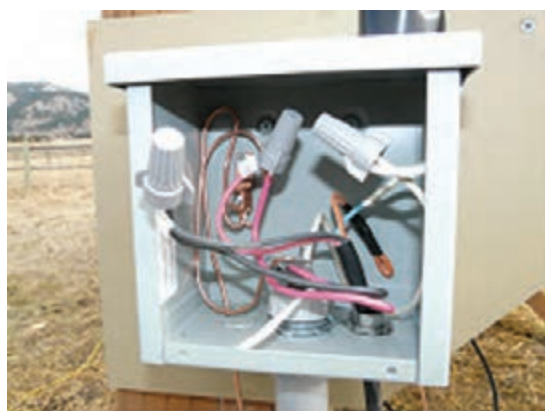
شکل ۳۵- اتصال میله مسی به بدنه تابلو اتصالات
