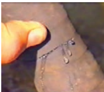
شکل ۶. نشتی از شیلنگ ها
