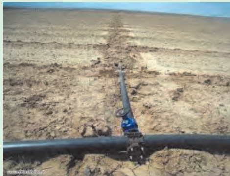
شکل ۴۶-۵. شیر فلکه لوله جانبی
