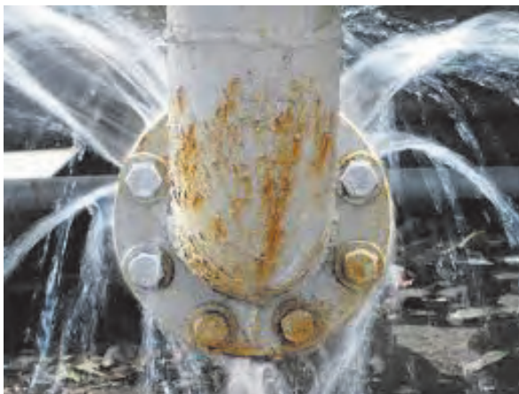
شکل ۲۴-۵. نشست آب بر اثر ضربه قوچ
