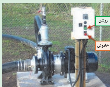
شکل ۲۸-۵. کلیدهای کنترل روی تابلو
