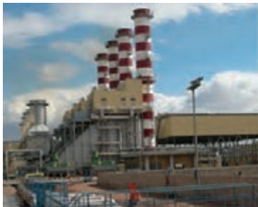
نیروگاه سیکل ترکیبی قم
