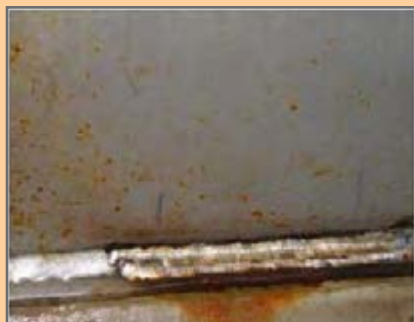
شکل ۴-۶- چگونگی سطوح خورده شده
