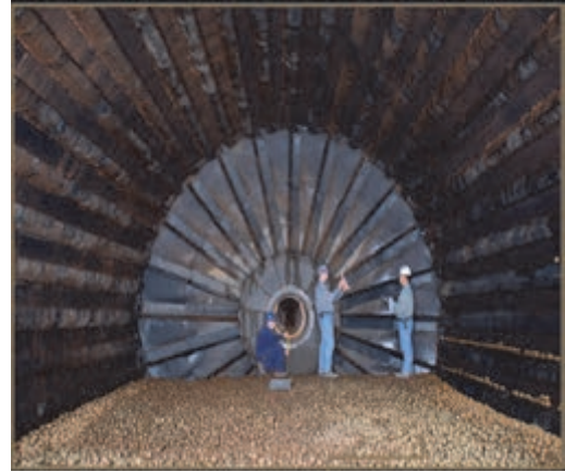
نمایی از داخل آسیای گلوله‌ای
