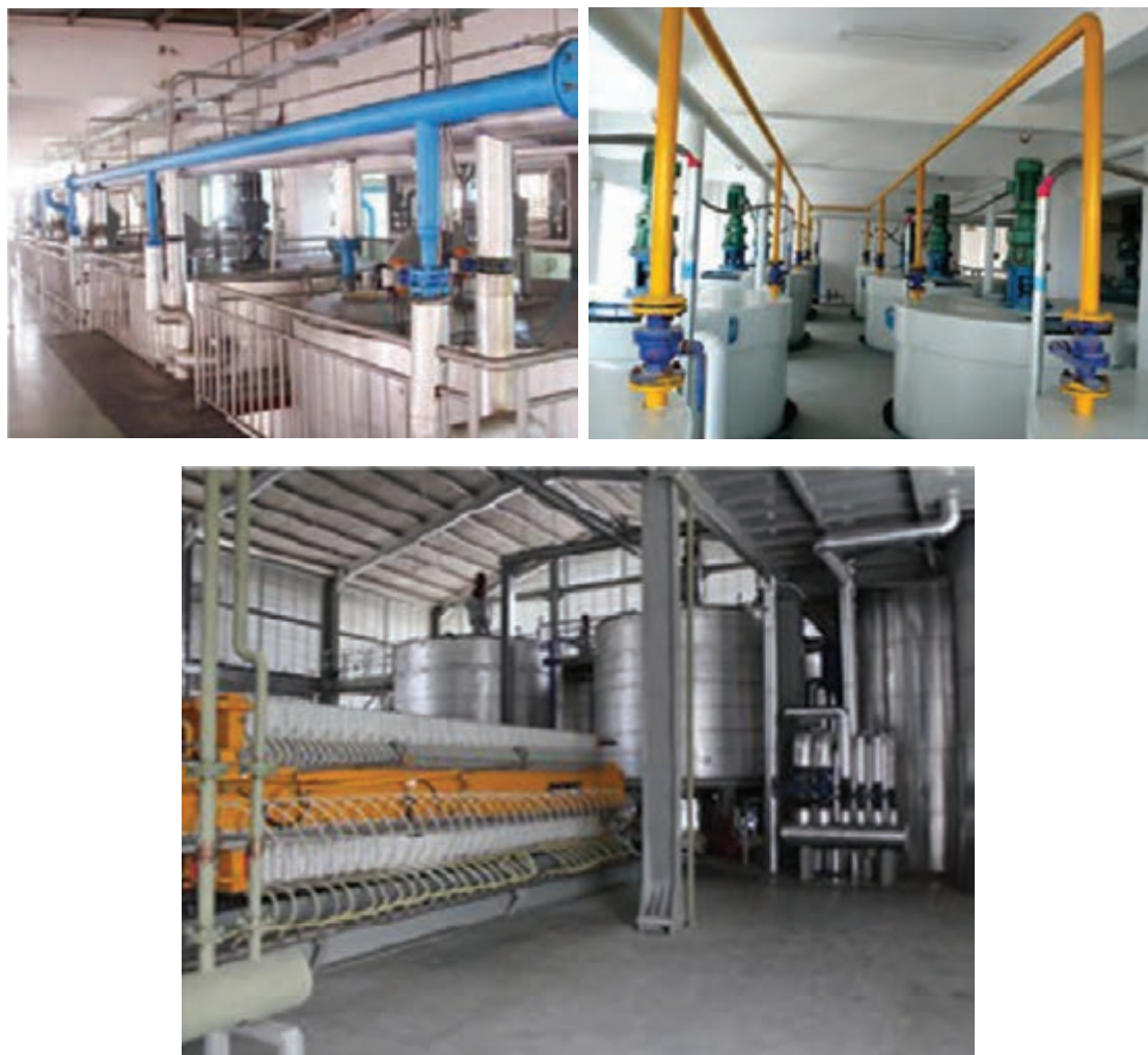
شکل ۱۰- سیستم تجهیزات جزء به جزء کردن روغن
