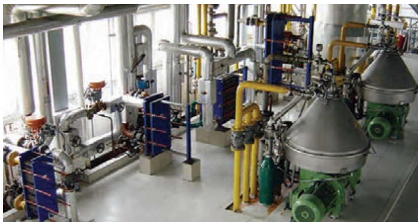
شکل ۶- سیستم خنثی‌سازی مداوم روغن
