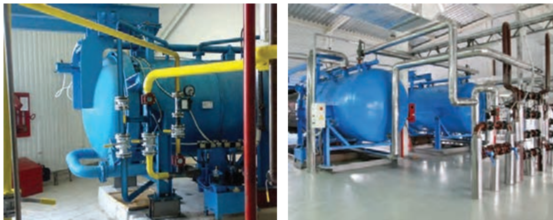
شکل ۱۲- سیستم زمستانه کردن روغن ها
