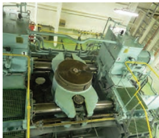
شکل ۳۷- تجهیزات اتاق سکان
