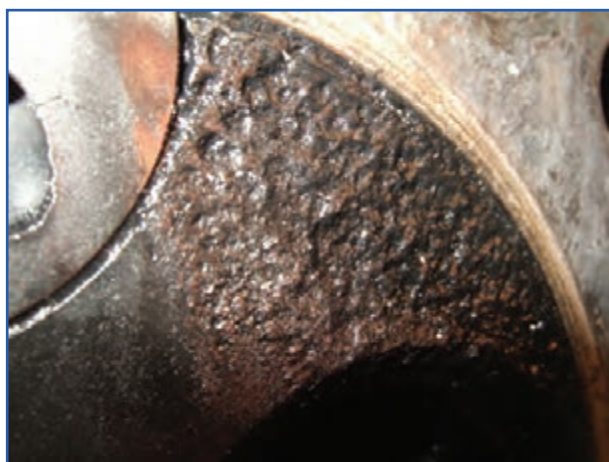
شکل ۲۷-۴- حفره‌های ایجاد شده بر اثر زنگ‌زدگی
