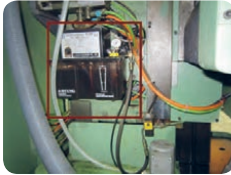
مکان نصب مخزن واحد مرکزی
