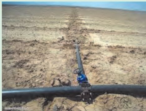
شکل ۴۶-۵. شیر فلکه لوله جانبی
