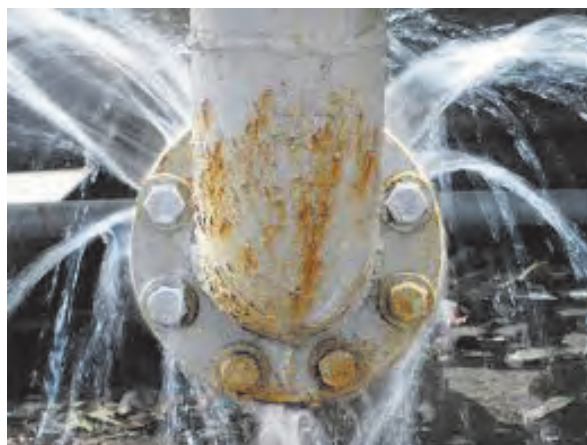
شکل ۲۴-۵. نشست آب بر اثر ضربه قوچ
