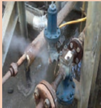
نشستی از خطوط لوله
