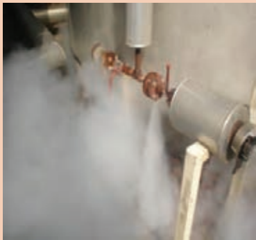
نشستی از اتصال در خط لوله
