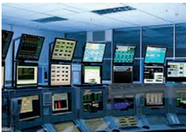
شکل ۲۸- نمایی از اتاق فرمان واحد
