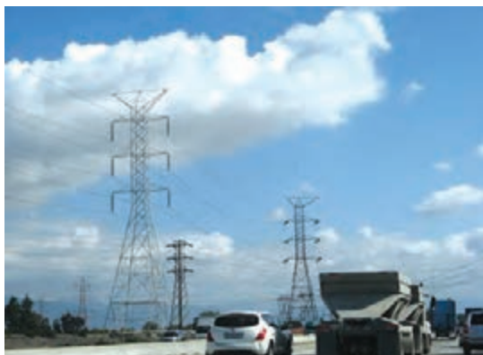
شکل ۵-۳- انتقال انرژی الکتریکی توسط دکل ها
