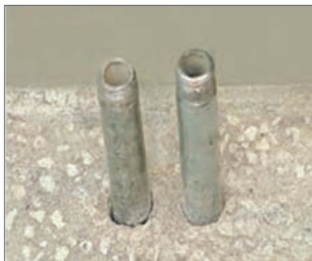
شکل لوله رفت و برگشت در کف
