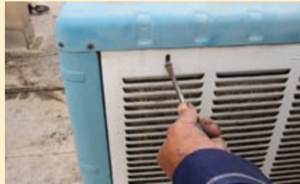
تنظیم آب پخش کن
