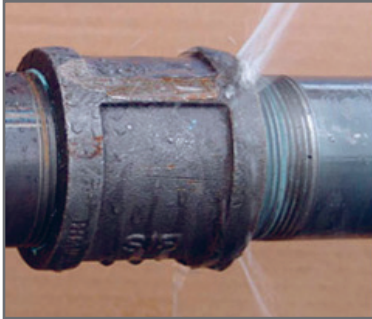
شکل ۱۱- یک اتصال در حال نشتی
