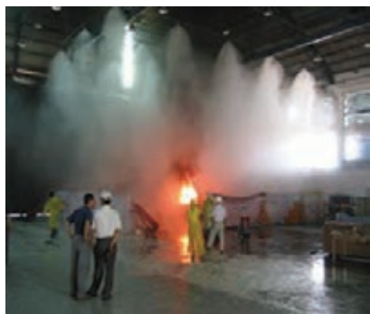
شکل ۱۱-۴- سیستم پاشش آب اطفاء حریق
