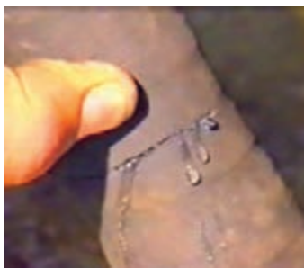
شکل ۶. نشتی از شیلنگ ها
