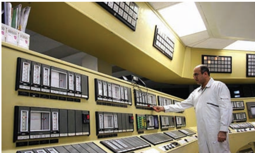
شکل ۳۴- اتاق فرمان موجود در پالایشگاه گاز
