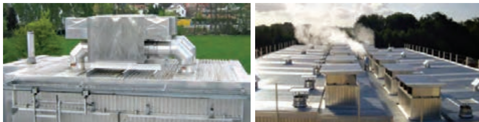
شکل ۶۲- دریچه‌های تخلیه هوا
