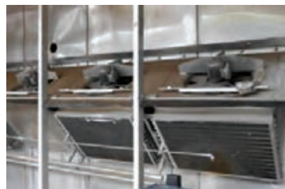
شکل ۴۰- انتقال حرارت کویل‌ها به وسیله فن‌ها
