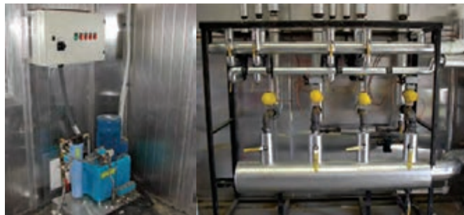
شکل ۶۰- شیرهای کنترل بخارزنی
