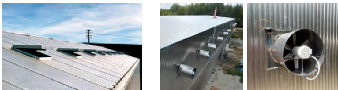
شکل ۴۴- دریچه‌های تخلیه هوا
