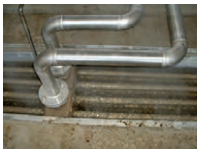
شکل ۶۱- کویل‌های حرارتی برای گرم کردن هوای کوره
