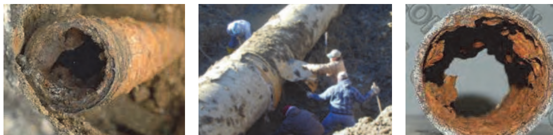
شکل ۴- نمونه‌ای از خوردگی لوله‌های دفن شده
