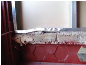
شکل ۷۱-۱- اجرای نامناسب رانر بر روی کف سازه‌ای
