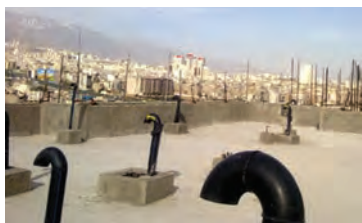
شکل ۲-۵۳ لوله‌های هواکش روی پشت‌بام
