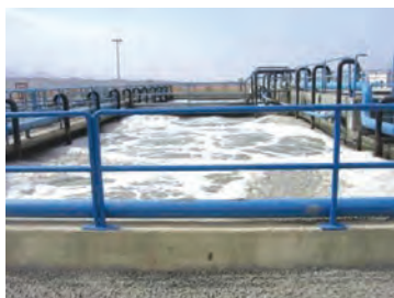
▲ شکل ۸-۲ تصفیه خانه آب
