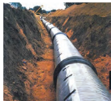
▲ شکل ۲-۲۲ لوله کشی انتقال آب شهری
