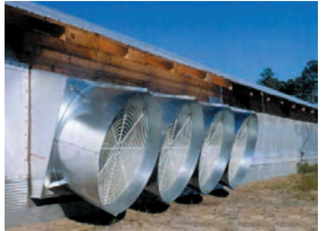
نمای هواکشها از بیرون جایگاه
