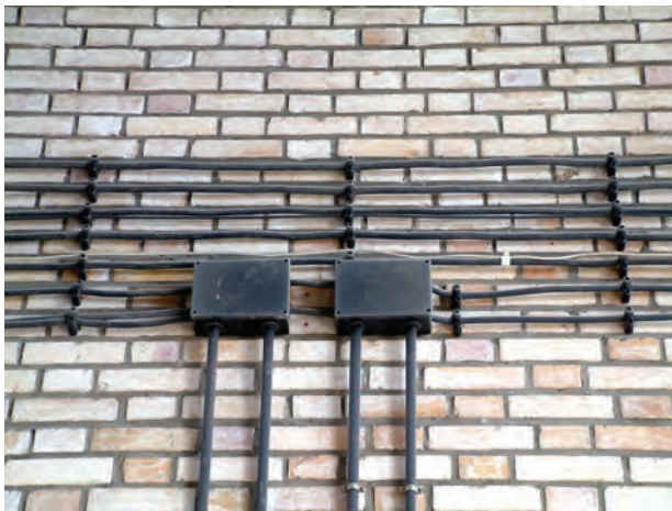
شکل ۵-۵۷- کابل‌کشی روی دیوار
