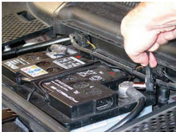
شکل ۲-۳۳- باز کردن اتصال بدنه‌ی باتری
