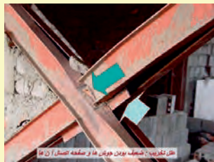
ضعیف بودن جوش و عدم اتصال مناسب
