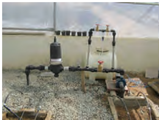
شکل ۱۴- نمونه‌ای از سیستم آبیاری گلخانه
