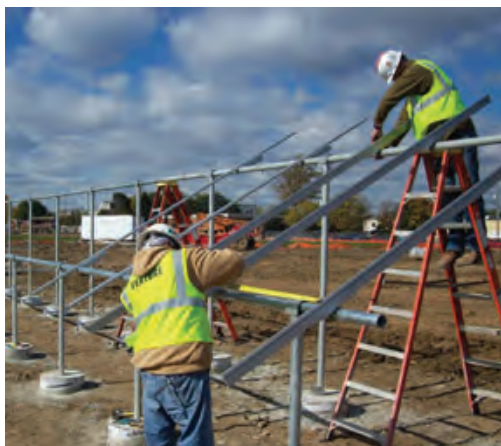
تصویر ۹ - سیستم های فتوولتائیک نصب شده بر زمین
