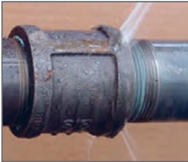
شکل ۱۱- یک اتصال در حال نشتی
