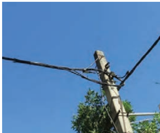
شکل ۲- کابل خود نگهدار
