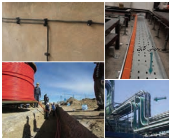
شکل ۱۹- انواع کابل کشی
