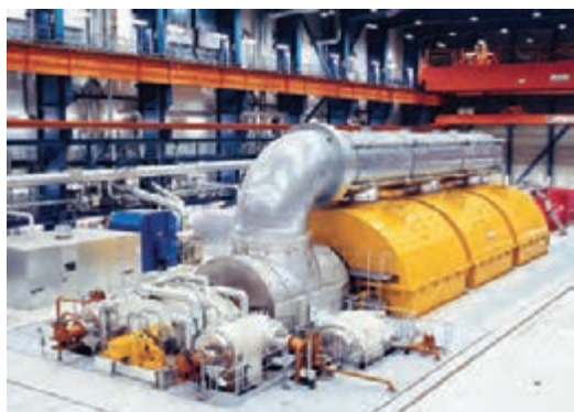
شکل ۲- ژنراتور سه فاز در نیروگاه
