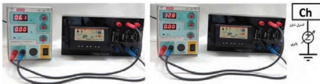
شکل ۱۸- تست کنترل شارژ
