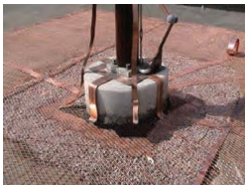
شکل ۴ - حلقه کلاف مسی به دور سازه فلزی برای همبندی
