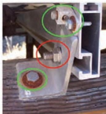
شکل ۵۶- پیچ متصل به سازه فرسوده شده است
