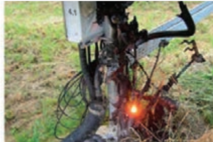
شکل ۳۶- سامانه فتوولتاییک بدون اتصال زمین که منجر به آتش سوزی شده است.
