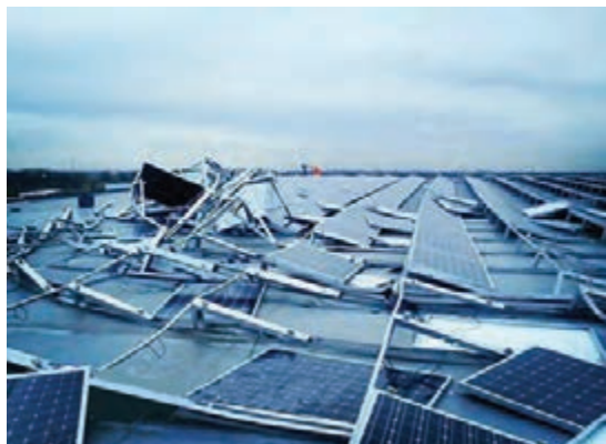
شکل ۶۰- پایه ضعیف در اثر باد شدید آسیب دیده است.
