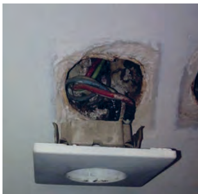
شکل ۳- قاب جداشده پریز از دیوار
