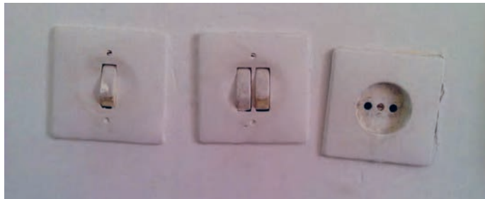
شکل ۱- نصب غلط کلید و پریز
