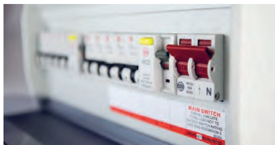
شکل ۷۹- تابلو توزیع برق واحد مسکونی
