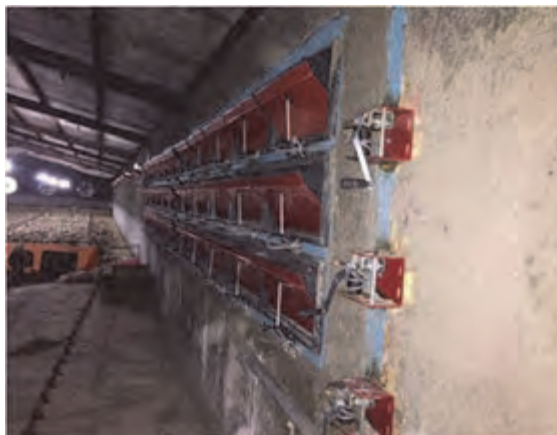
ورود هوا از طریق پنجره‌های خودکار (اینلت)
