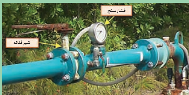
شکل ۱۳- محل شیرفلکه و فشارسنج روی لوله رانش
