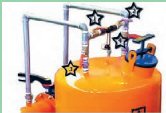
شکل ۳۲- اتصال مخزن کود به لوله اصلی ۱- شیرهای برگشت (By pass)، ۲ و ۳- شیرهای ورودی و خروجی مخزن ۴- شیر فلکه روی لوله اصلی
