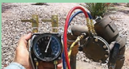
شکل ۱۷- تنظیم فشار شیر فشارشکن
